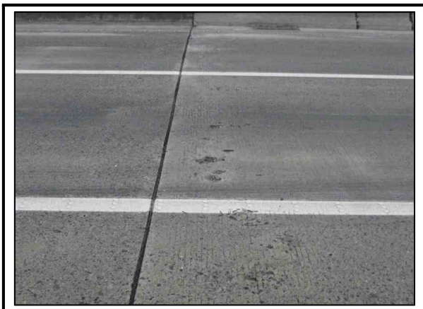
사진번호 71 포장부 S21 파손, 패임 외관망도 10-6
