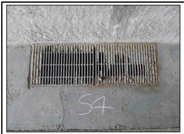
사진번호 55 집수구 S4 이물질 퇴적, 그레이팅 부식 외관망도 2-29
