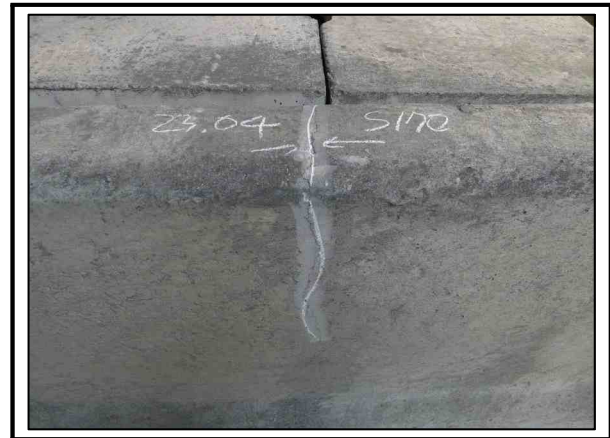
사진번호 68 공동구 S170 측면 외관망도 76-6 균열(0.3mm미만)
