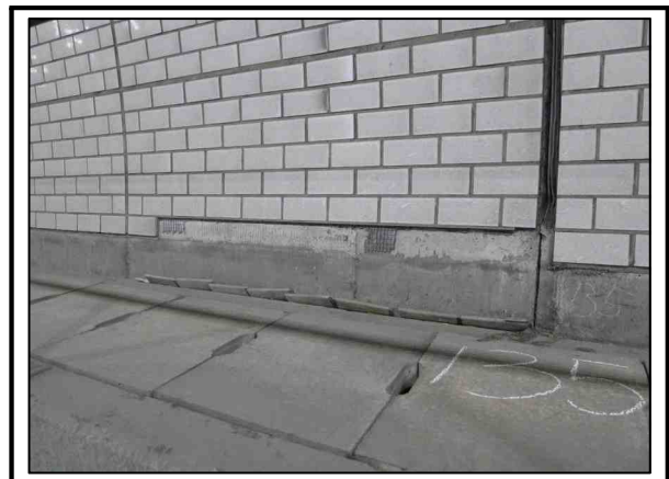
사진번호 42 측벽부 S135 외관망도 60-8 좌측 타일탈락, 파손
