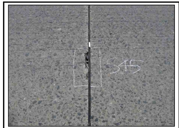
사진번호 72 포장부 S45 외관망도 20-20 줄눈 주변 파손
