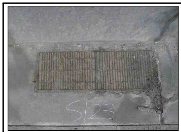
사진번호 58 집수구 S123 이물질 퇴적, 그레이팅 부식 외관망도 55-1
