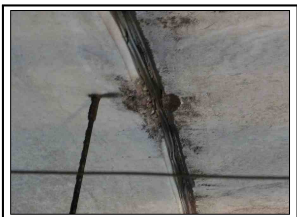
사진번호 35 천단부 S92(J92) 외관망도 41-5 마감불량
