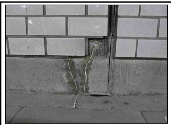
사진번호 41 측벽부 S113 외관망도 51-5 좌측 타일탈락, 파손
