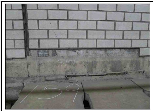
사진번호 45 측벽부 S159 외관망도 71-2 좌측 타일탈락, 파손
