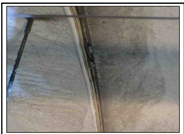
사진번호 33 천단부 S76(J76) 외관망도 34-14 시공이음부 박락
