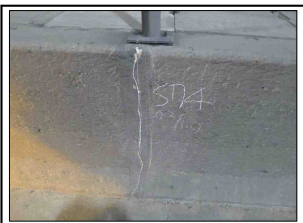
사진번호 65 공동구 S74 측면 외관망도 33-12 균열(0.3mm 이상)
