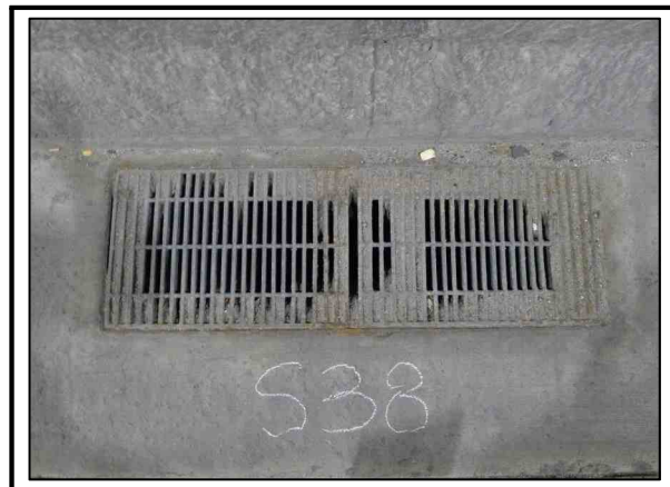
사진번호 56 집수구 S38 이물질 퇴적, 그레이팅 부식 외관망도 17-9
