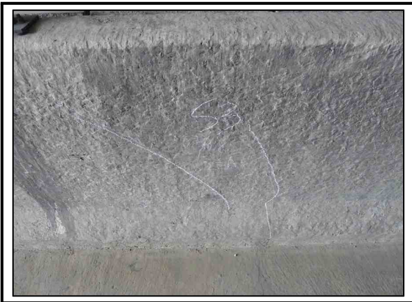
사진번호 61 공동구 S16 측면 외관망도 7-2 균열(0.3mm 미만)
