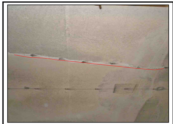
사진번호 24 천단부 S32 보수부 재균열(0.3mm미만) 외관망도 14-5
