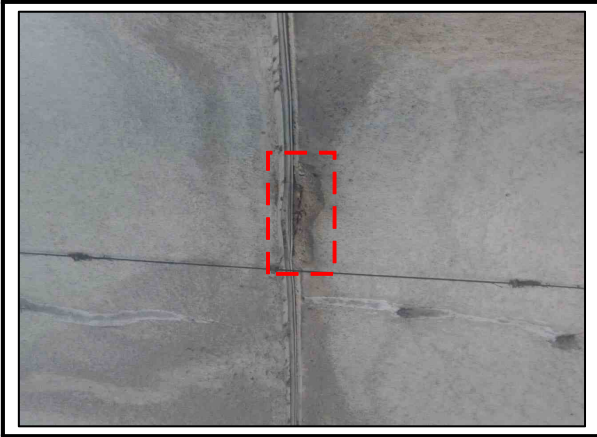
사진번호 37 천단부 S140(J140) 외관망도 63-10 시공이음부 박락
