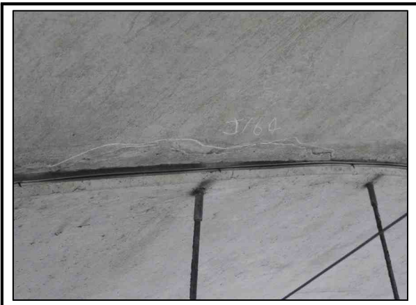
사진번호 39 천단부 S164(J164) 외관망도 73-7 시공이음부 박락
