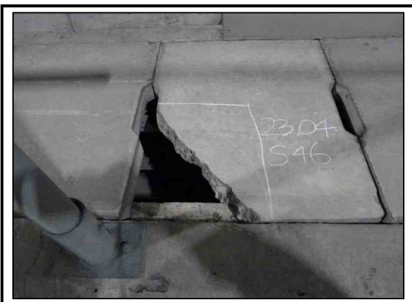
사진번호 63 공동구 S46 외관망도 21-5 좌측 덮개 파손
