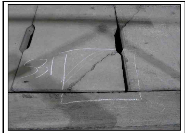
사진번호 62 공동구 S31 외관망도 14-7 좌측 덮개 파손
