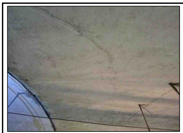
사진번호 34 천단부 S92 외관망도 41-3 균열(0.3mm미만)
