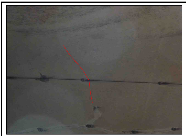
사진번호 23 천단부 S25 균열(0.3mm미만) 외관망도 11-9
