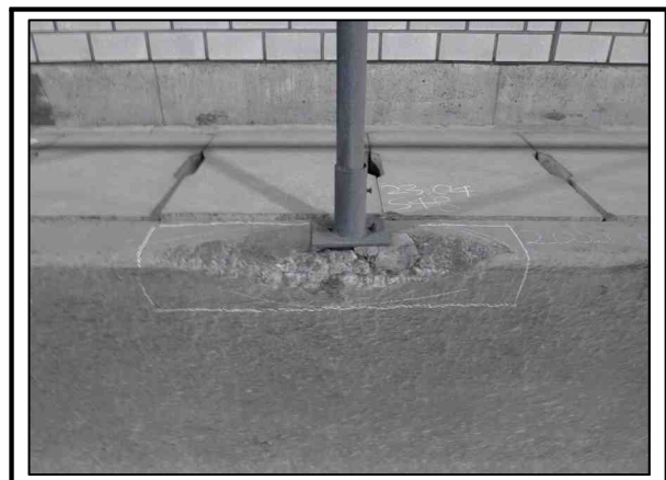
사진번호 64 공동구 S48 좌측 파손 외관망도 22-7
