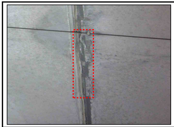
사진번호 32 천단부 S70(J70) 외관망도 31-5 시공이음부 박락
