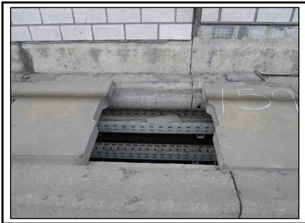
사진번호 67 공동구 S159 외관망도 71-5 좌측 덮개 탈락
