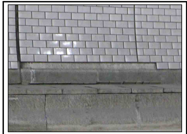
사진번호 40 측벽부 S106 외관망도 48-9 우측 타일탈락, 파손
