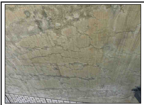
사진번호 21 천단부 S2 망상균열 외관망도 1-2
