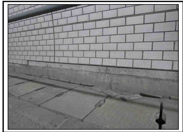
사진번호 44 측벽부 S143 외관망도 64-8 우측 타일탈락, 파손
