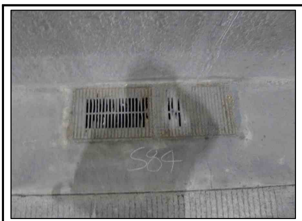
사진번호 57 집수구 S84 이물질 퇴적, 그레이팅 부식 외관망도 38-7
